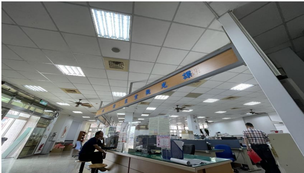
主要作業空間照明現況照片
